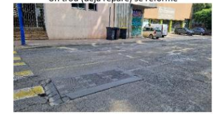
Dégradation au niveau de chambres techniques
