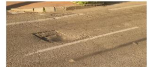
Un trou (déjà réparé) se reforme
